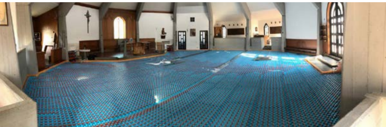
Chiesa | Roma - Impianto radiante a pavimento con pannello Variplus
