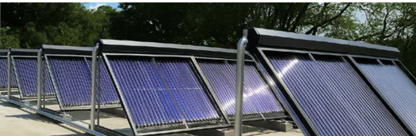
Scuola S. Casciano | Siena - Impianto solare con pannelli 1100 HP
